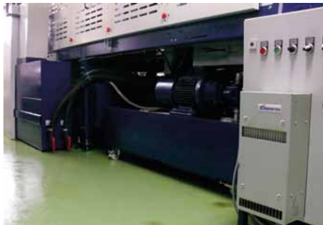
Bild 2: Die neue Generation der Hochdruck-Anlagen ist platzsparend unter dem Magazin untergebracht
